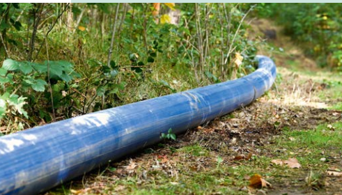
Mitten im Wald nahe Oschatz werden komplett neue Trinkwasserleitungen in die Erde gebracht.
